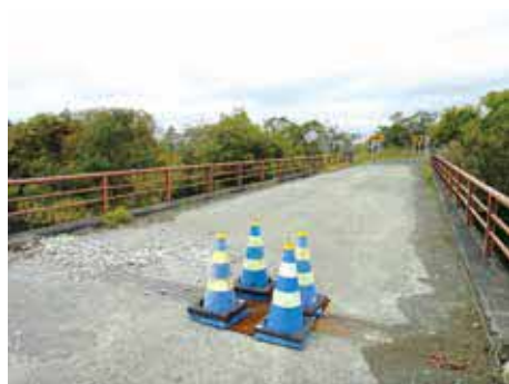
改修工事が待たれる二本松橋
